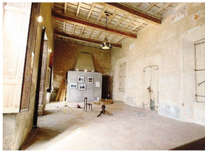
Il salone con il camino protetto da un tavolato contro gli atti vandalici
